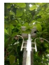
Gambar 2. Lampu Taman Rusak Sedang
