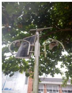
Gambar 3. Lampu Taman Rusak Berat
