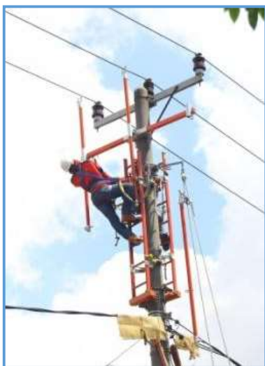
Gambar 10. Pemasangan Peralatan Inovasi pada Jaringan SUTM 20 kV PLN Area Surabaya Selatan dengan Metode Berjarak
